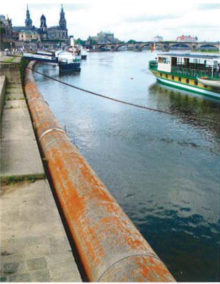
Abbildung 4: Vorbereitend erfolgte der Aufbau einer Interimsentwässerung als Kombination aus Freigefälledruckleitung und Heberleitung
