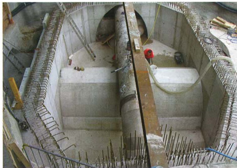
Abbildung 3: Bau des Kreuzungsbauwerks Carolabrücke, mit dem das Kreuzen des AAK und des Kaitzbaches neu gestaltet wird
